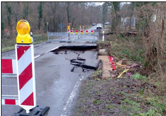
Abbildung 4: private Aufnahme – Unterspülung Straße in Verlängerung der Maiblumenstraße auf Höhe der Südpfalz-Kaserne
