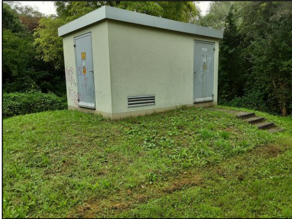
Abbildung 55: Trafostation im Umfeld Schöpfwerk Kleinreingraben
