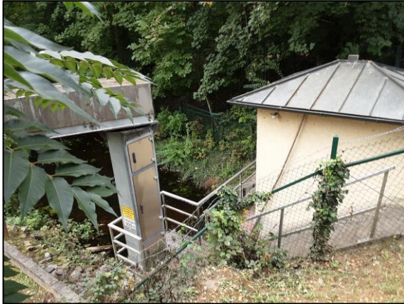
Abbildung 37: Schöpfwerk an Mündung Bornpfuhl in Queich
