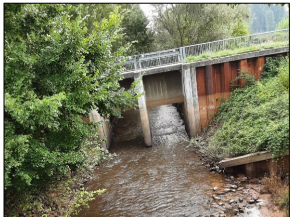
Abbildung 21: öffentliche Ortsbegehung 07.09.2021; Schöpfwerk, Alte Schiffbrückenstraße
