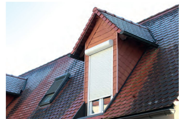
✗ Unzulässige Mischung von Dachfenstern und Dachaufbauten
